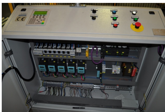
PANNELLO DÌ CONTROLLO CON PLC
